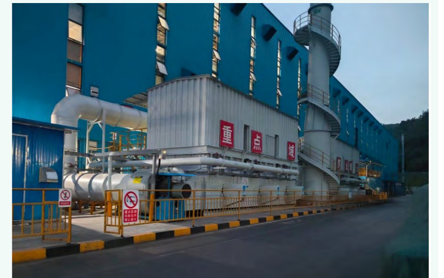
四川贝特瑞 RTO 废气处置设施
